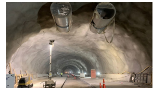
Ventilación Túnel AVO I
