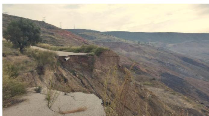
Ilustración 2 Rotura en vía de acceso a la mina por un deslizamiento de ladera.
