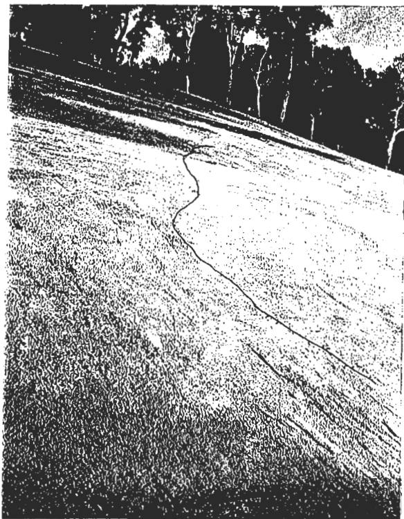
Fotografía N° 2.- Vista del inicio de apertura de las fracturas en el talud V-I
