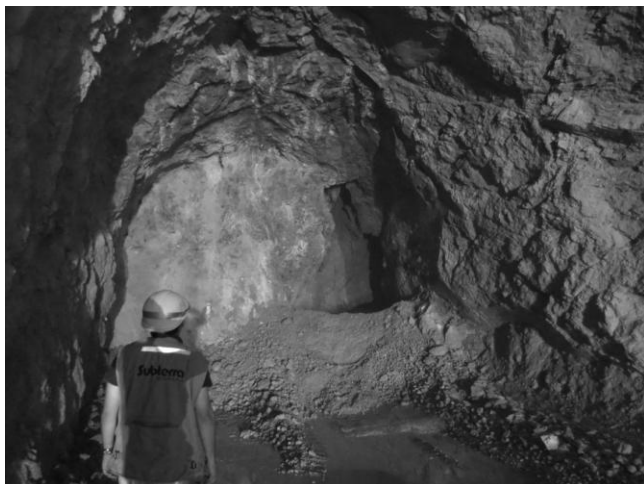
Fotografía 1. Vista general de la caverna aparecida entre los PP.KK. 3+132.0 y 3+124.0 en el frente 4 del Túnel 1.
